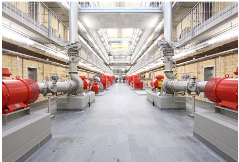
Насосна станція Фраснахт, РВСГ
