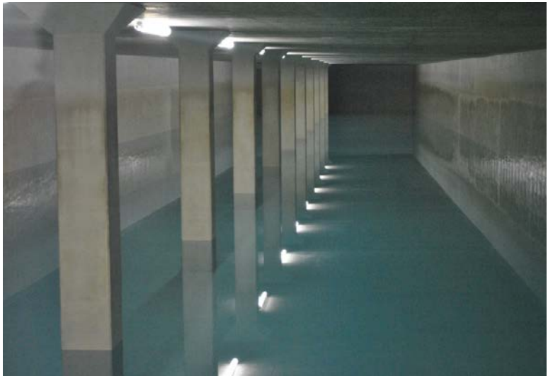
Резервуар питної води, що належить Групі водопостачання
